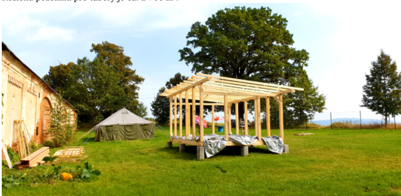
Stavba přístřešku pro nepříznivé počasí. Vzadu stan, který je také k dispozici.
