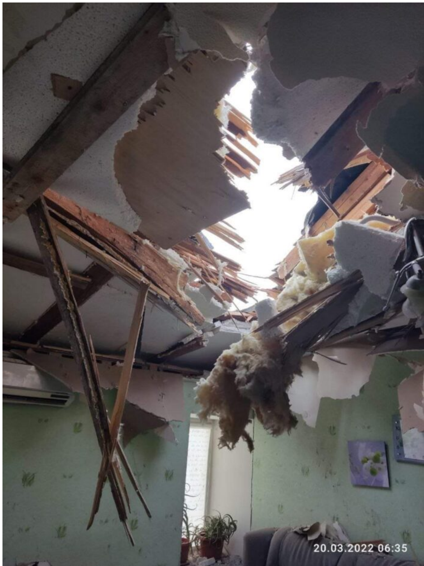
Raketa prorazila střechu a strop.
