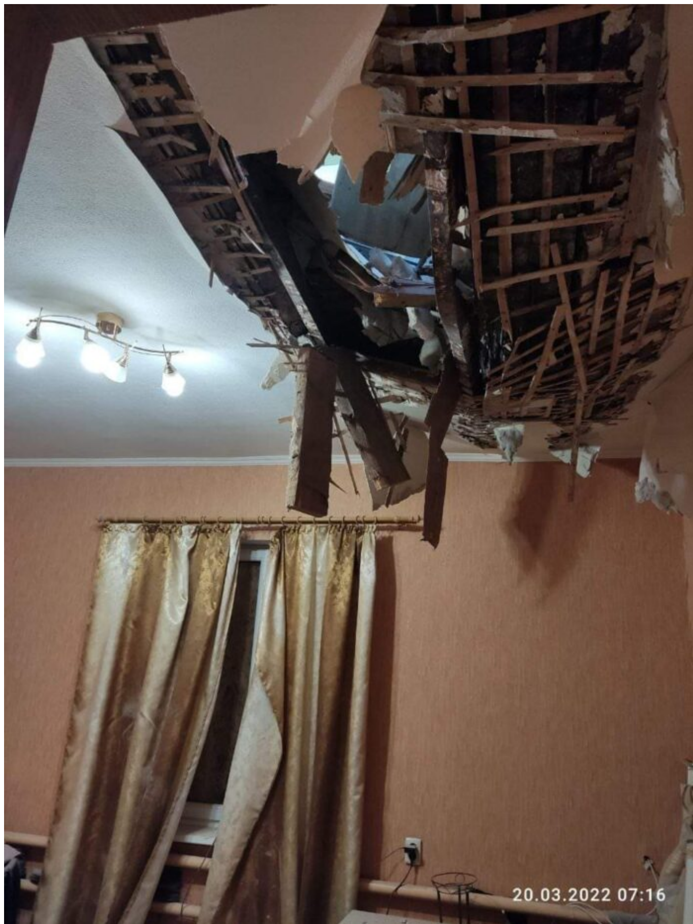
Raketa prorazila střechu a strop.
